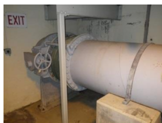
Biotower effluent pipe
